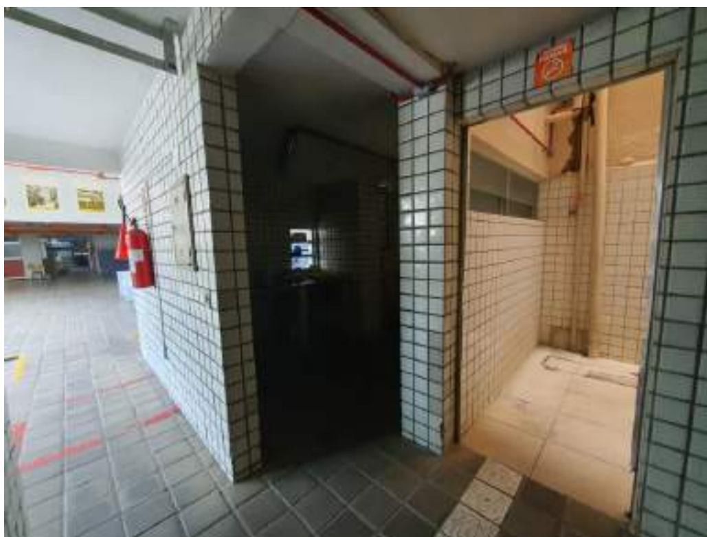
18 Antiga copa a esquerda e a direita porta de acesso a cozinha, vestiários e serviço.
