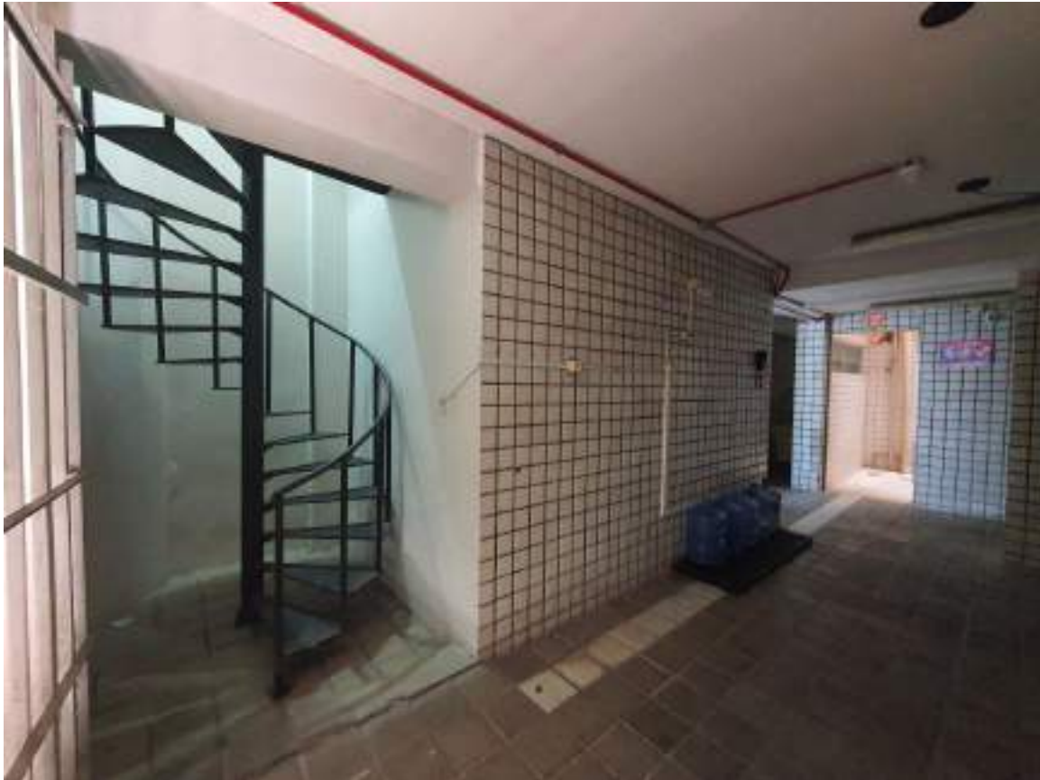
24 Escada de acesso aos camarins. À direita, copa suja.
